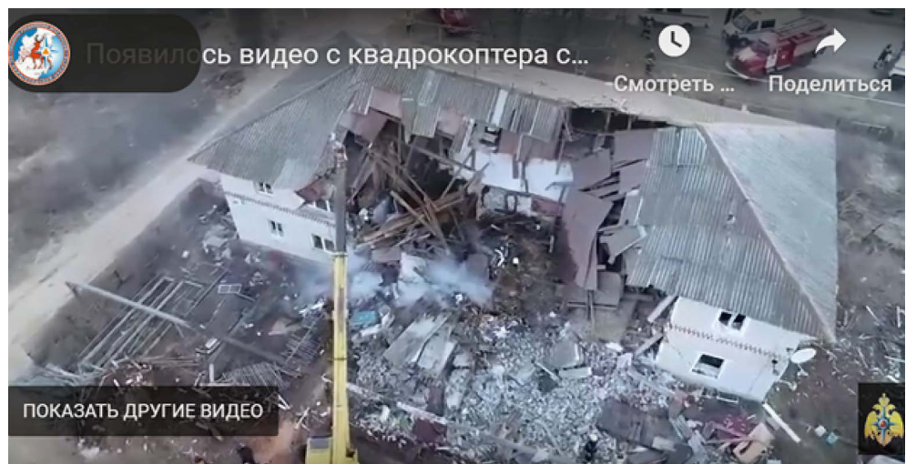
Последствия взрыва газовоздушной смеси в жилом многоквартирном доме. Разрушение перекрытий и несущих конструкций. Село Филинское Вачского района Нижегородской области. 7 апреля 2020 года. Кадр из видео, анонсированного МЧС России.
