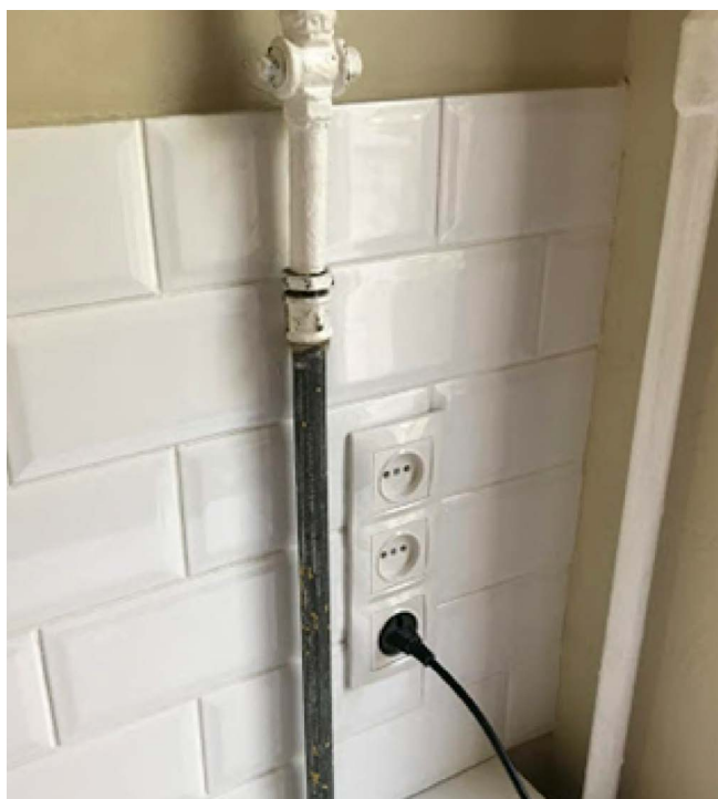
Несоблюдение минимального расстояния от газопровода до электрических розеток на кухне жилого многоквартирного дома. Фото из сети Интернет.
