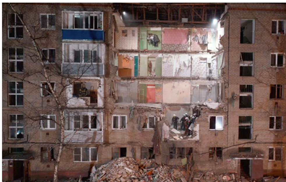
Последствия взрыва газовой смеси в жилом многоквартирном доме. Частичное обрушение подъезда. Орехово-Зуево, Московская область. 4 апреля 2020 года.
