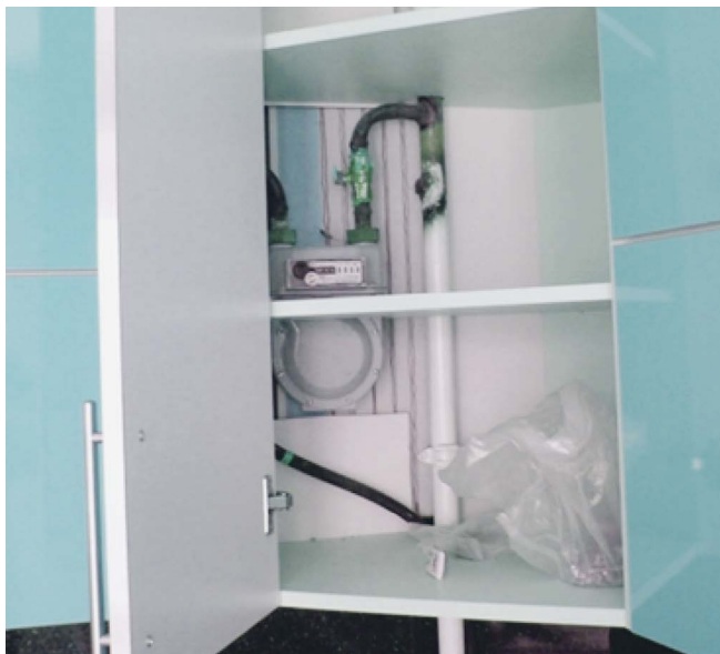
Ограничение свободного доступа к газовой сети, перекрываемому вентилю и прибору учета газа в жилом многоквартирном доме, путем установки кухонного гарнитура. Транзит электрического кабеля рядом с газовыми коммуникациями.
