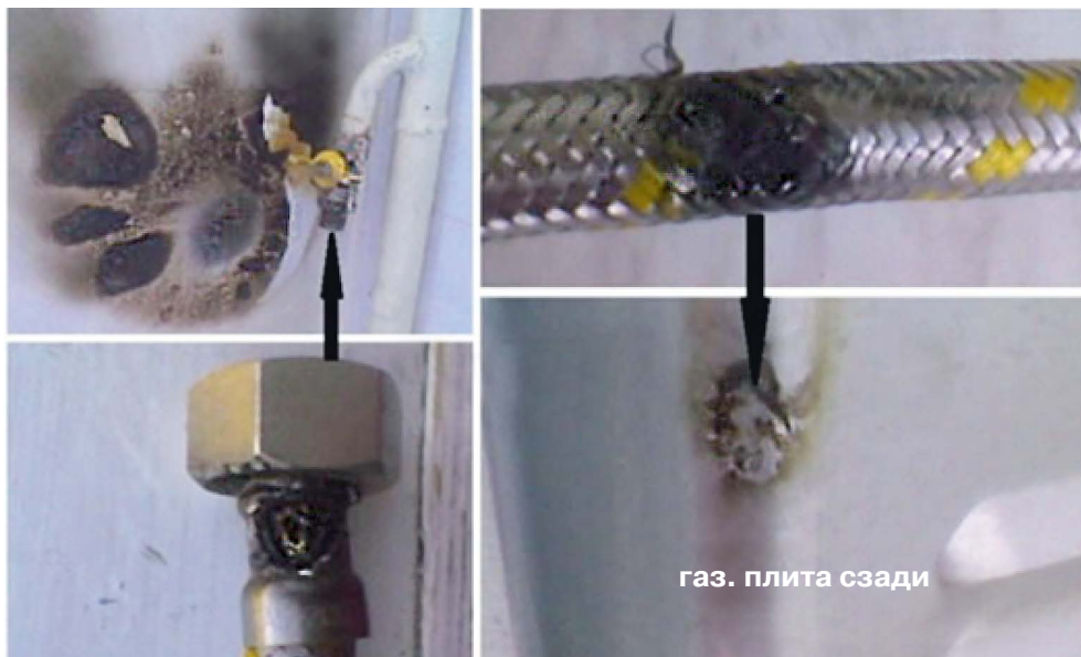
Место разгерметизации гибкого соединительного газового шланга.
