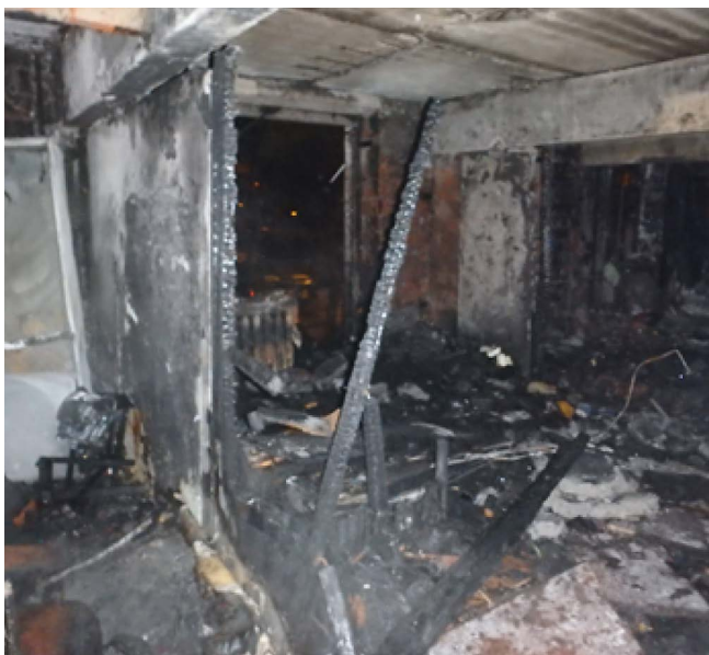
Вид разрушений квартиры.
