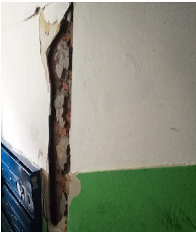
Вид смещения стены между кухней квартиры и лестницей в подъезде.
