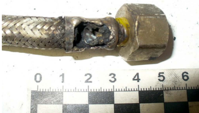
Место разгерметизации гибкого соединительного газового шланга.
