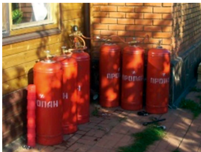
Групповое размещение баллонов с газом у стены частного жилого дома с грубым нарушением требований пожарной безопасности. Фото из сети Интернет.
