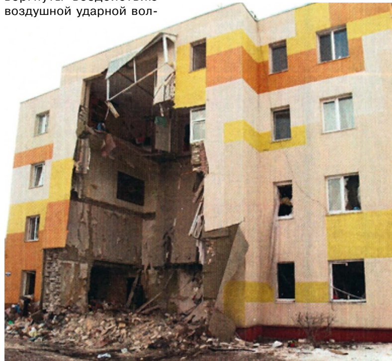
Разрушения выступающей части фасадной стены дома.
